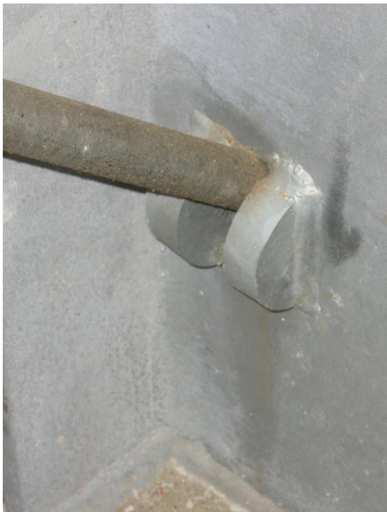
Hier ist die Verstärkung wirkungslos
