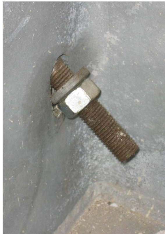
Hier fehlt die Verstärkung
